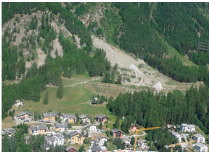
Lawinverbauung oberhalb von Pontresina
